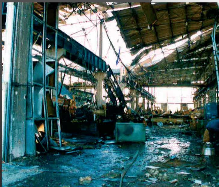
Разрушенный цех фабрики предприятия «14 октября» в г. Крушевац
